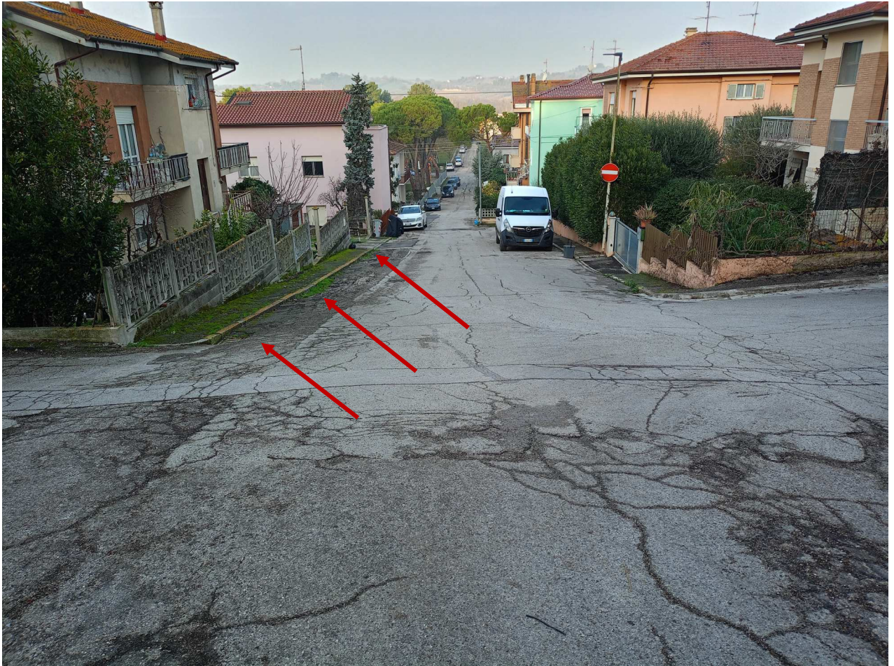
Tratto finale con marciapiede deteriorato
