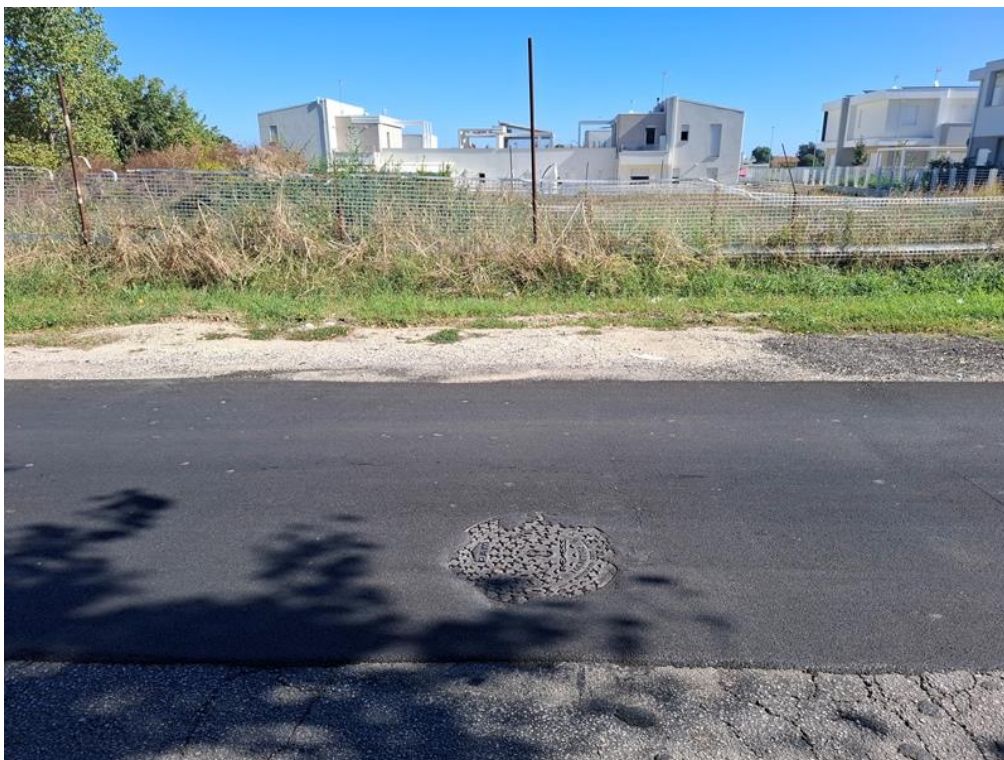
FOTO N. 15 - POZZETTO ALLACCIO FOGNATURA ACQUE NERE
