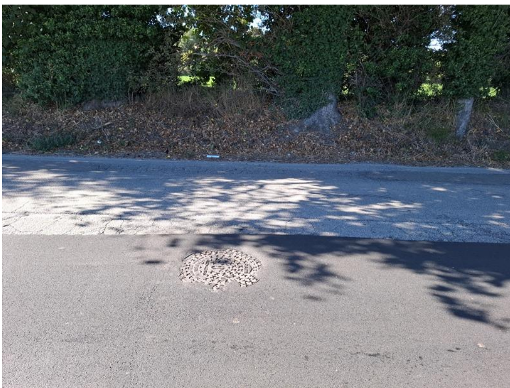
FOTO N. 14 - POZZETTO ALLACCIO FOGNATURA ACQUE NERE
